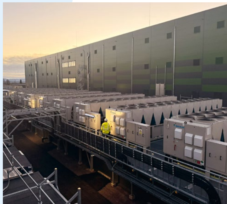
OSL-Hamar: Green Mountain Hyperscale-Rechenzentrum, Norwegen
